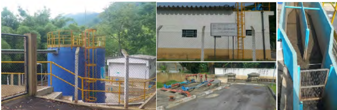
Figura 65: Na sequência, ETE Bairro Souza's, ETE São Benedito/ Elevatória São Benedito e o tratamento preliminar.
