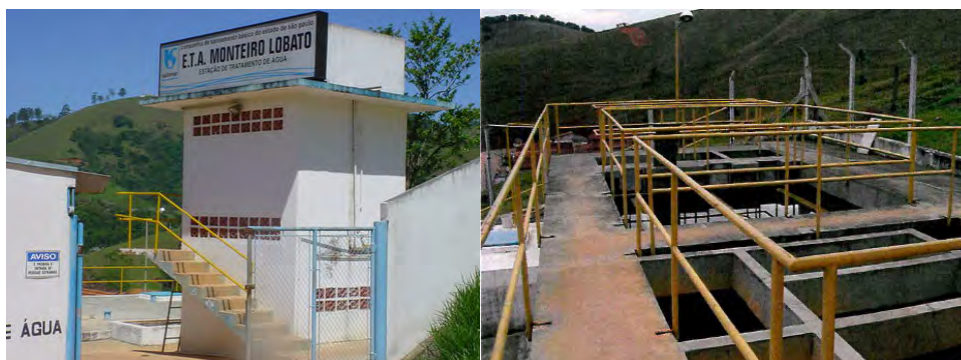
Figura 60: ETA Sede de Monteiro Lobato, vistas da entrada e das unidades de floculação e decantação.
