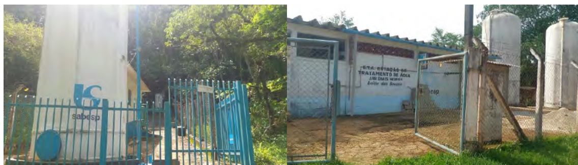
Figura 62: Reservatório do bairro São Benedito e ETA Jair Dimas Moreira no bairro Souza
