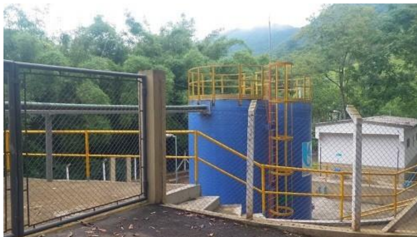
Figura 80: ETE Bairro Souzas.
