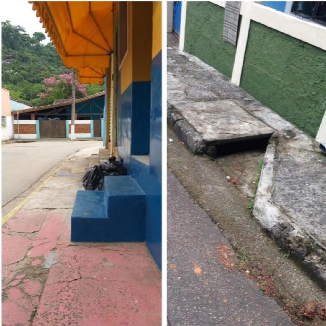
FIGURA 23 – Foto in loco evidenciando má qualidade nas calçadas e falta de rampa para acessibilidade.
