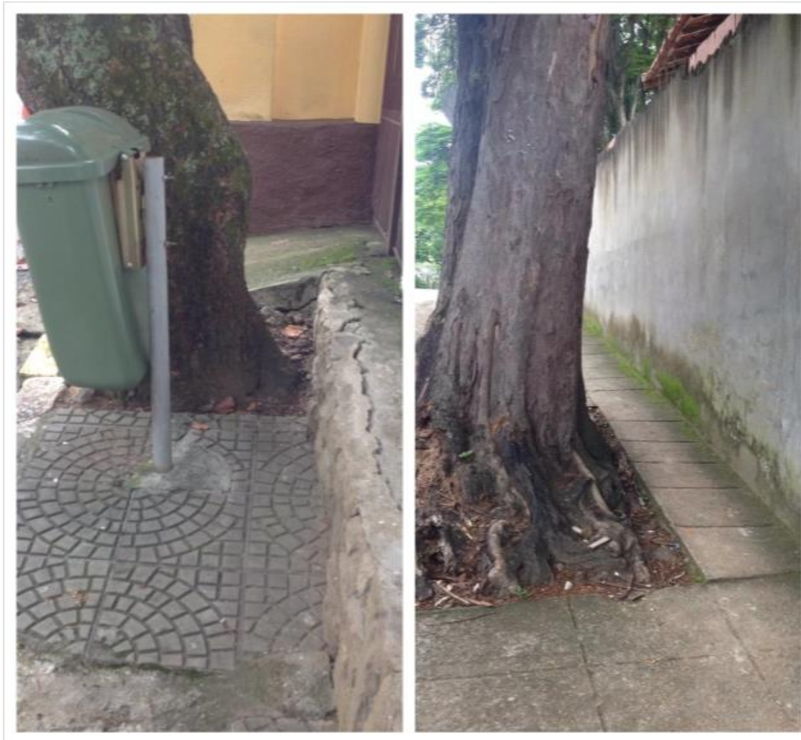
FIGURA 55 – Foto in Loco de dois locais com Árvores obstruindo Calçadas.
