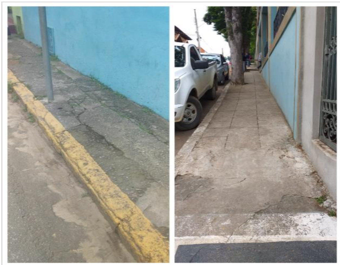
FIGURA 22 – Foto in loco, mostra o estado de má conservação das calçadas da cidade na rua Maria Luiza Valvano Auricchio.
