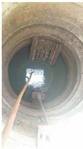
Figura 83: Poço do Sistema Elevatório São Benedito que recebe o Esgoto e possui os resíduos coletados por empresa terceirizada periodicamente.
